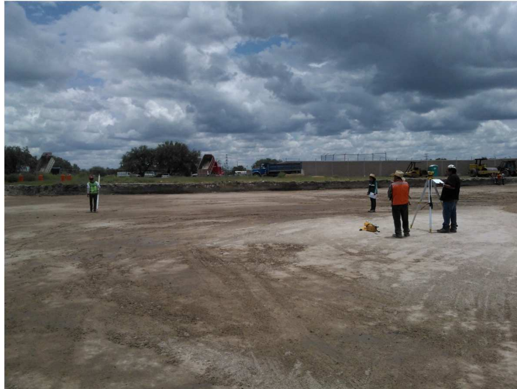
UNIVERSIDAD TECNOLÓGICA DE SAN LUIS POTOSÍ RANCHO NUEVO SOLEDAD DE GRACIANO SANCHEZ, S.L.P. AMPLIACIÓN DEL ESTACIONAMIENTO ORIENTE.
